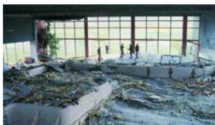
1985 versagte die abgehängte Betondecke eines Hallenbades im schweizerischen Uster. Die Aufhängungen der Decke aus nichtrostendem Stahl A2 zeigten rein äußerlich keinerlei Mängel, waren jedoch innerlich teilweise vollkommen durch Spannungsrissskorrosion zerstört.
